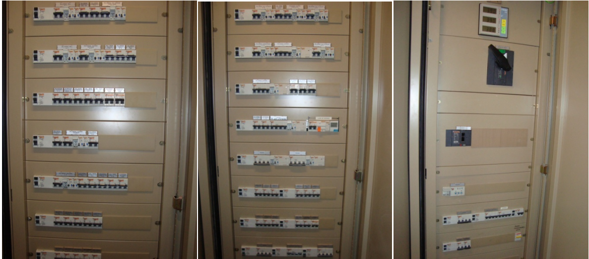
Figura 3. Quadre elèctric general
