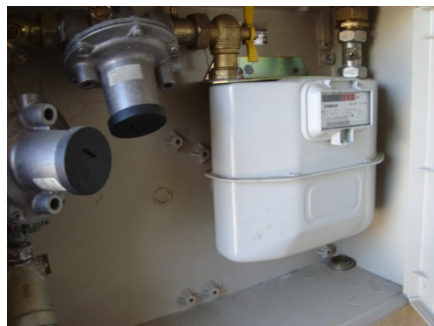
Figura 4. Comptador de gas natural
