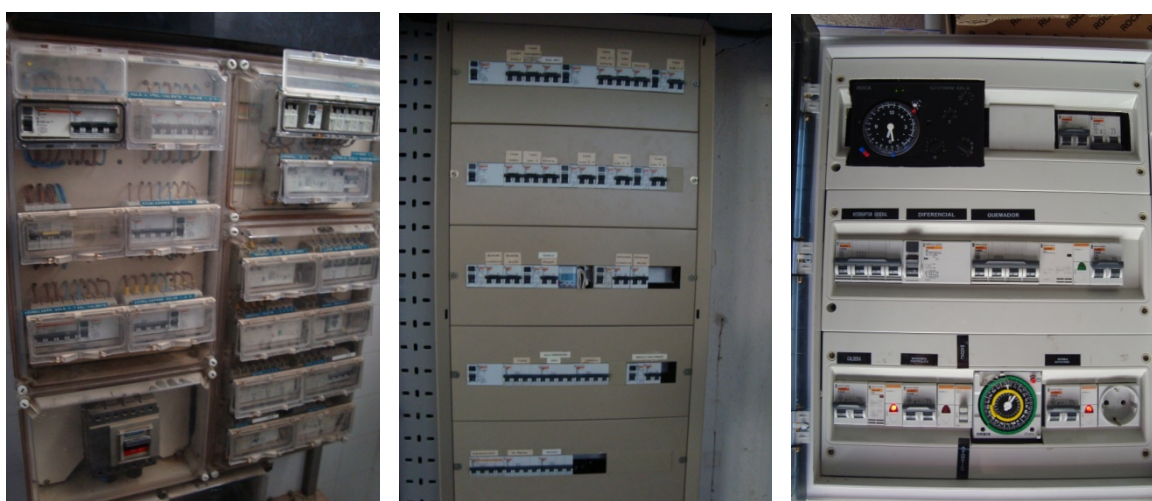
Figura 2 Quadre elèctric general
