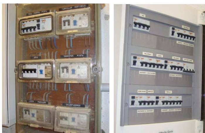
Figura 3 Quadre elèctric general
