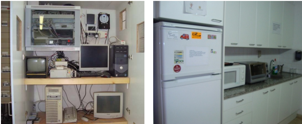
Figura 7. Altres equips elèctrics
