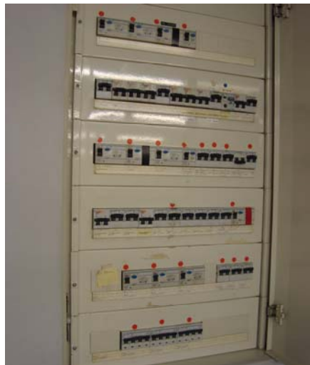
Figura 3 Quadre elèctric general
