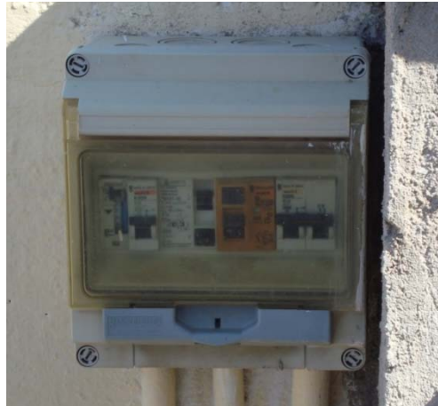
Figura 3. Quadre elèctric general
