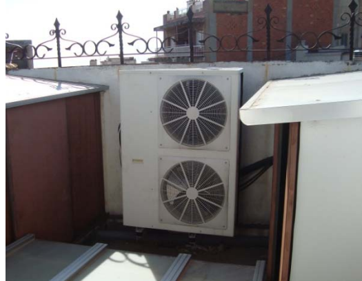
Figura 4. Equip de climatització
