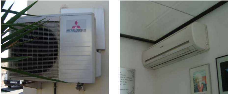
Figura 8. Equips de climatització
