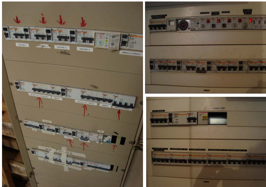
Figura 2. Quadres elèctrics Vil·la Flora
