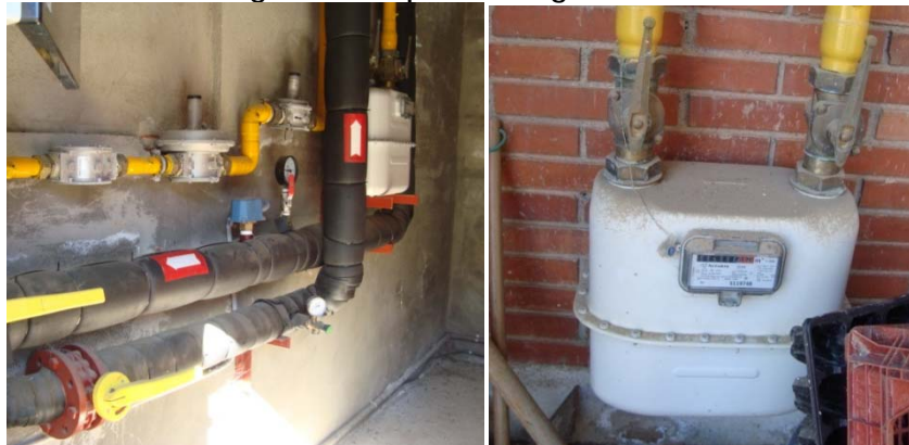
Figura 3 Comptadors de gas natural
